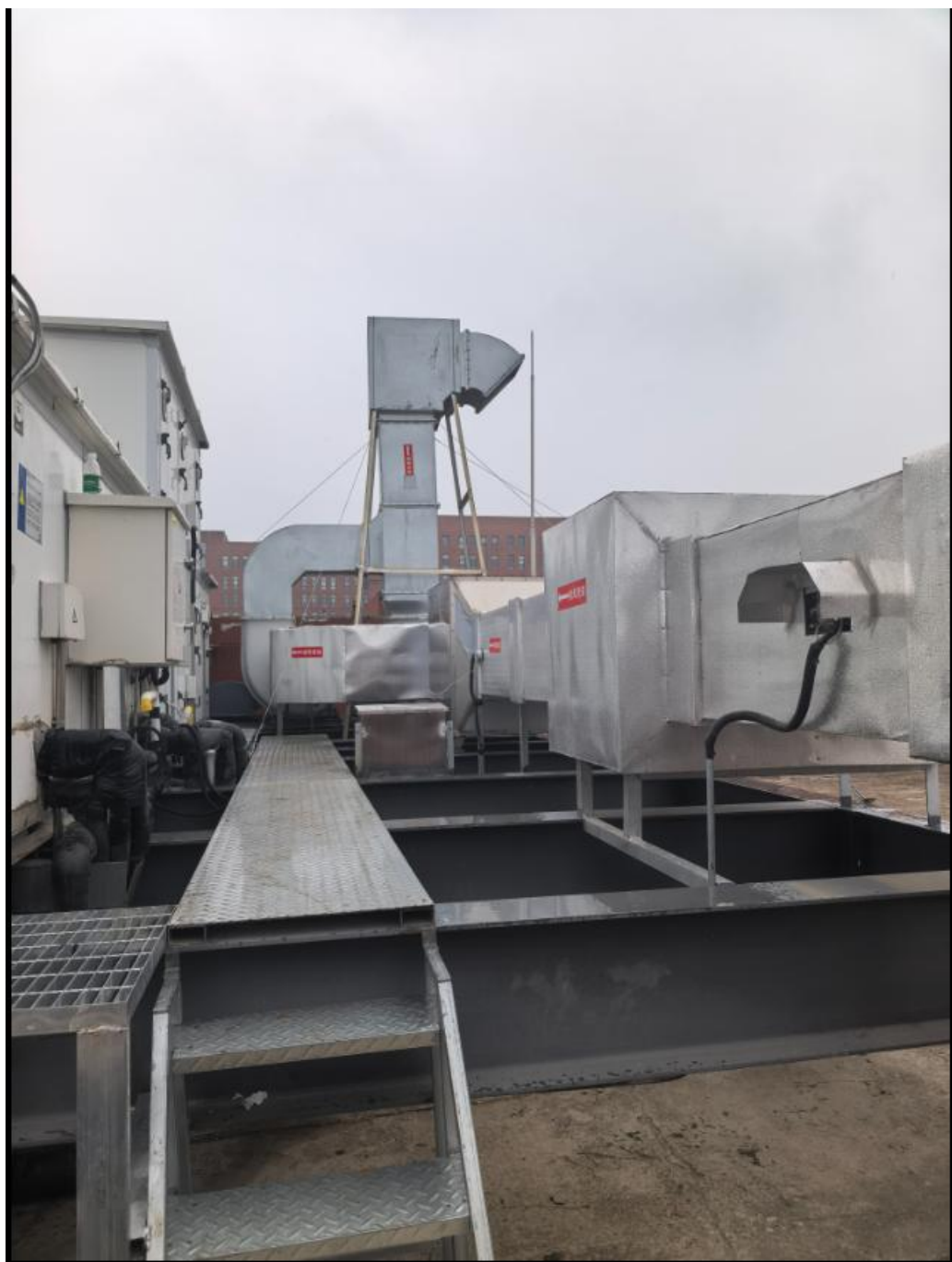
附图 1 废气治理设施照片
